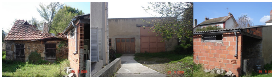
2 État de dégradation important des bâtiments situés dans la dent creuse avant les travaux portés par la commune - photos avant réalisation (2008) (source : mairie de Marmagne)
