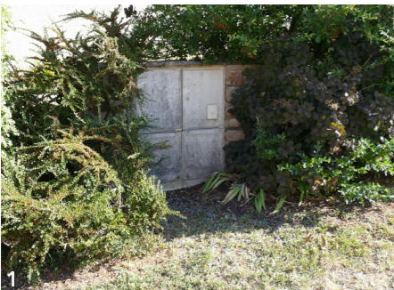
1 Intégration des coffrets électriques dans le mur en pierre et haie bocagère en limite de parcelle
