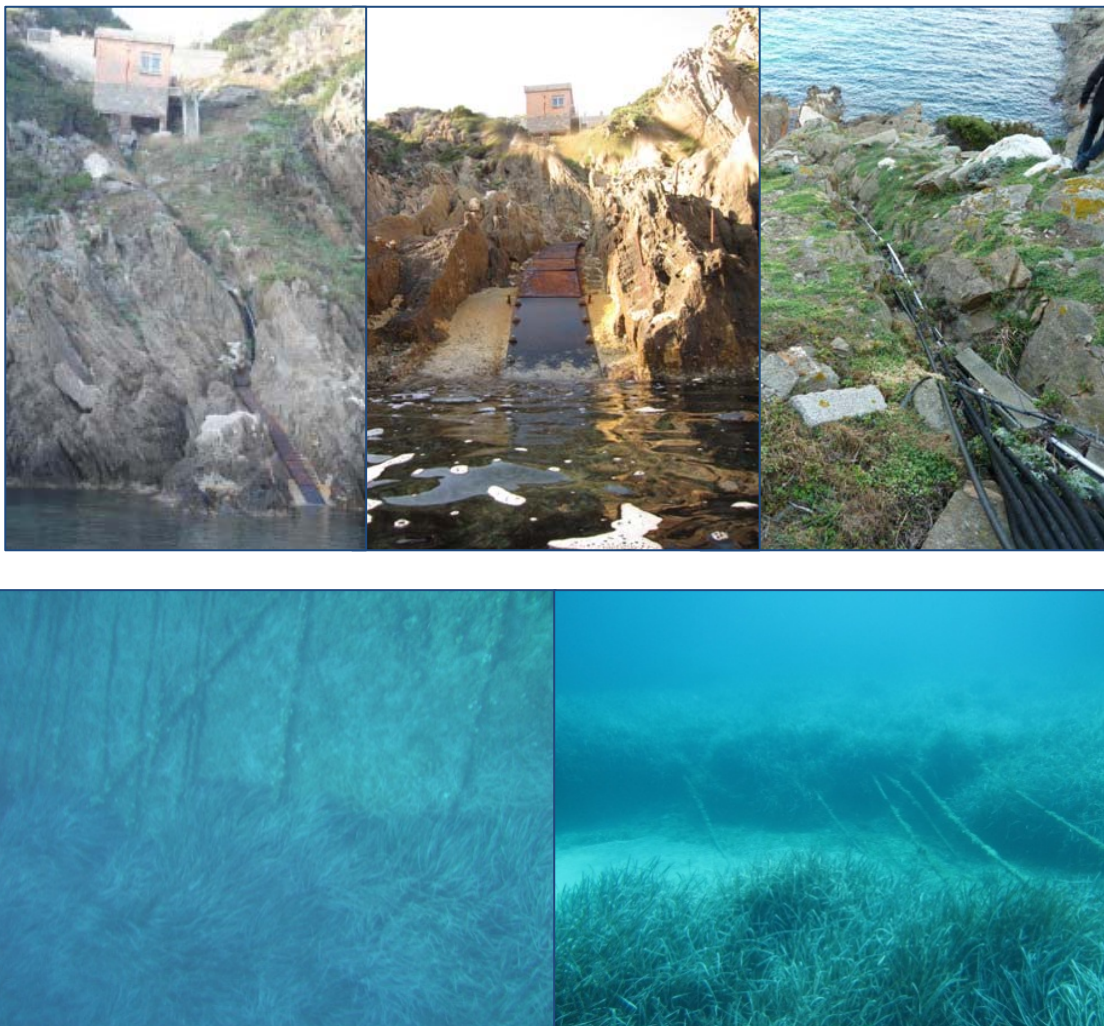
Figure 11 - Vue de la goulotte DGA et du départ des câbles Trémil
