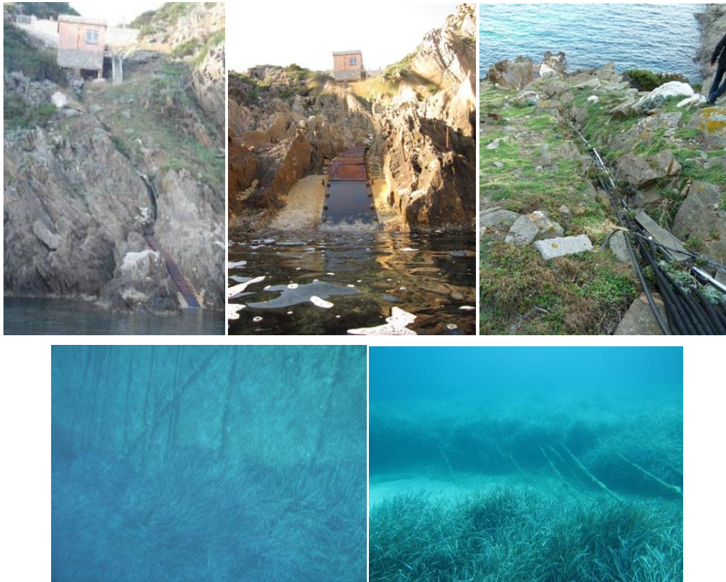
Figure 3 – Vue de la goulotte DGA et du départ des câbles Trémil
