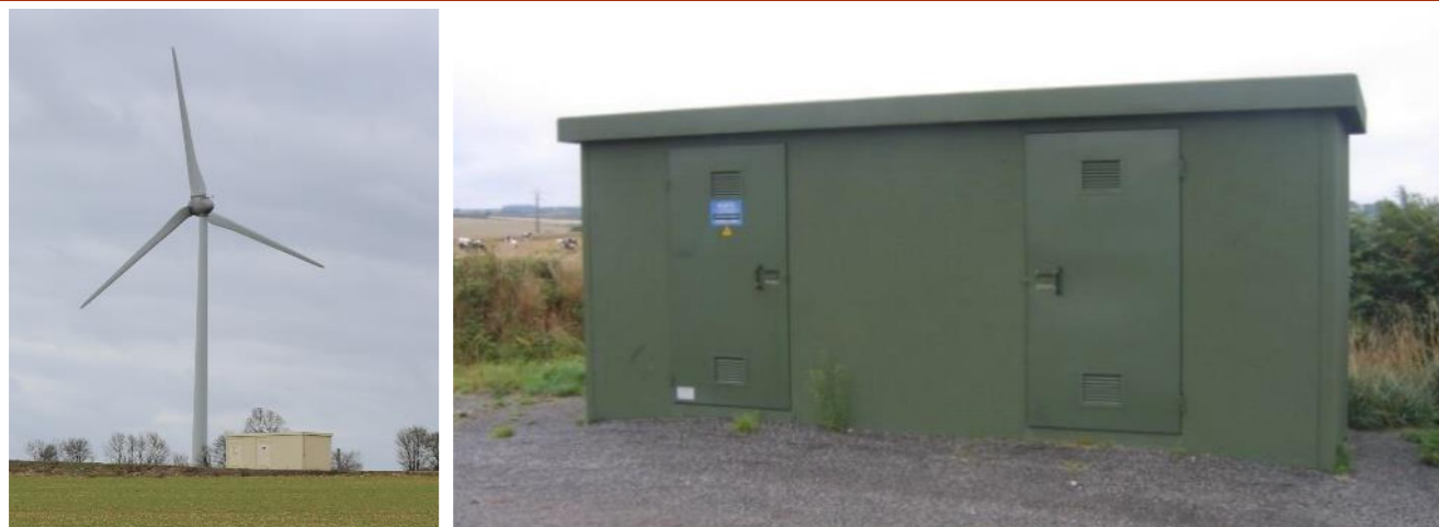
Photo 5 : Exemples de poste de livraison électrique
