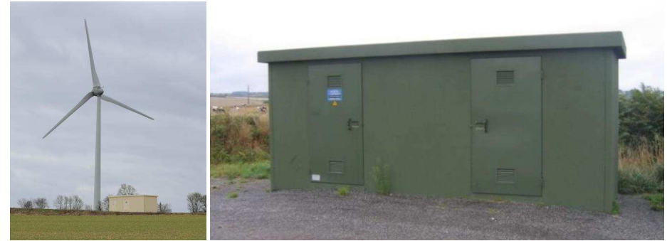
Photo 129 : Exemples de poste de livraison électrique
