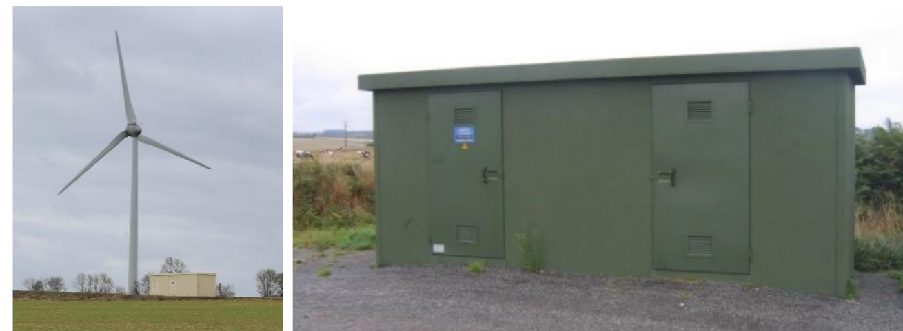
Exemples de poste de livraison électrique
