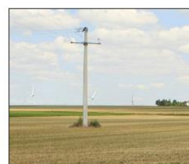
Ligne électrique à Connantre
