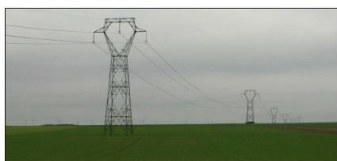
Ligne électrique à Faux-Fresnay
