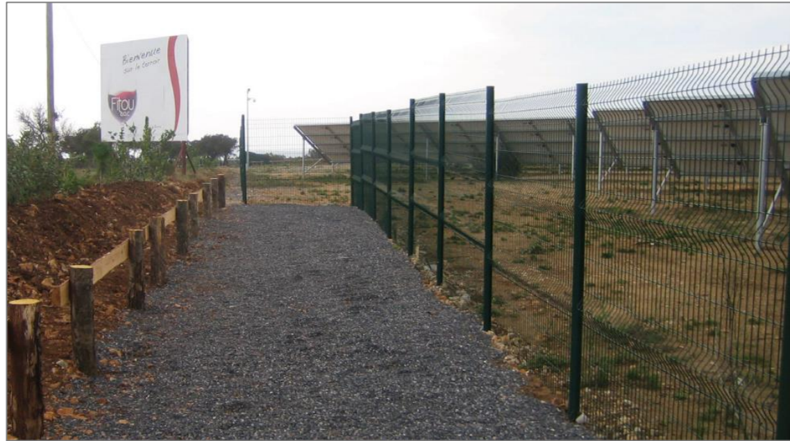
Figure 13 : Exemple de clôture d'enceinte d'une centrale solaire photovoltaïque au sol
