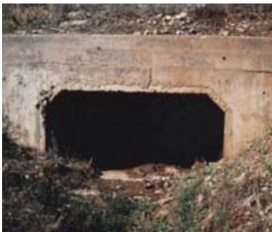
Exemple de passage protégé pour herpétofaune (dalot). © Setra 2009
