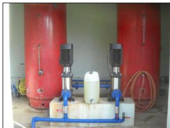
Figure 13 : Réservoir et station de traitement / distribution
