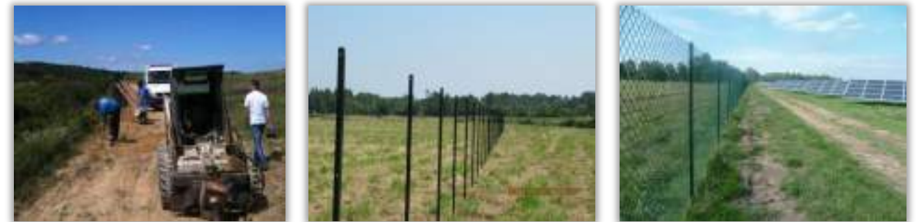
Mise en place de la clôture : pose des ancrages, des piquets et du maillage
