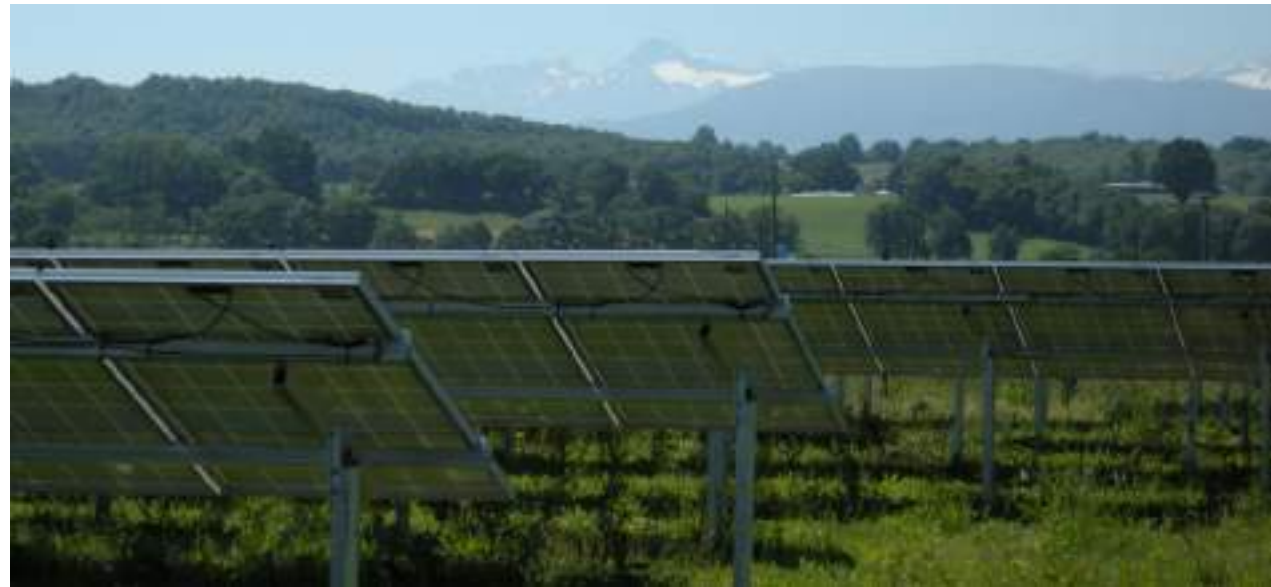
Parc solaire photovoltaïque de Saint-Martory (31)
