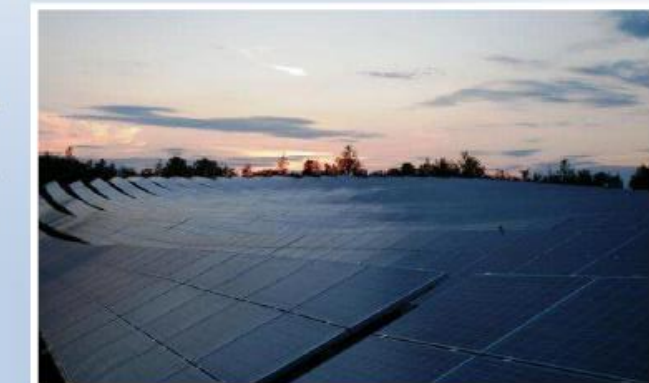
Centrale Solaire du SYCALA Département : Lot (46) Puissance électrique : 8 000 KWc Mise en service : Juin 2011
