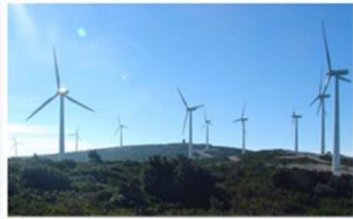
Parc de TUCHAN Département : Aude (11) Puissance électrique : 11,7 MW 18 éoliennes Mise en service : 2001-2002-2009
