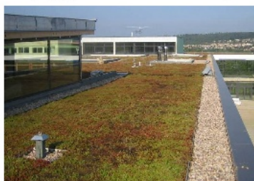
Photo 10 : Toiture végétalisée (Copyright : CETE de l'Est – J. Schwager)
