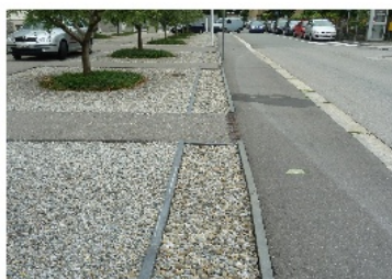
Photo 7 : Tranchée drainante (Copyright : CETE de l'Est – A. Gerolin)
