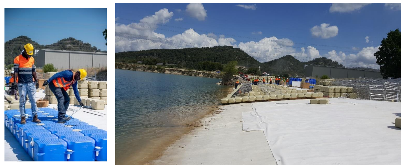
Figure 99 : Zone de montage et de mise à l'eau – Parc des Chapeliers (source : BORALEX, 2021)
