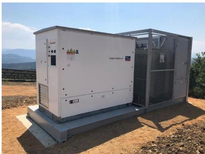
Figure 94 : Illustration d'un poste de transformation
