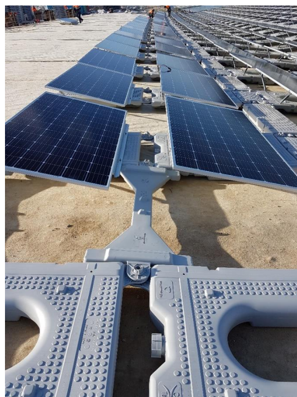
Figure 93 : Exemple de structures flottantes – Parc de Piolenc (source : BORALEX, 2021)
