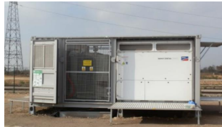
Figure 85 : Exemple de modules intégrant transformateurs et onduleurs (source : dossier de permis de construire)
