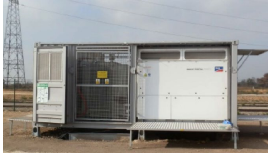
Figure 49 : Exemple de modules intégrant transformateurs et onduleurs (source : dossier de permis de construire)
