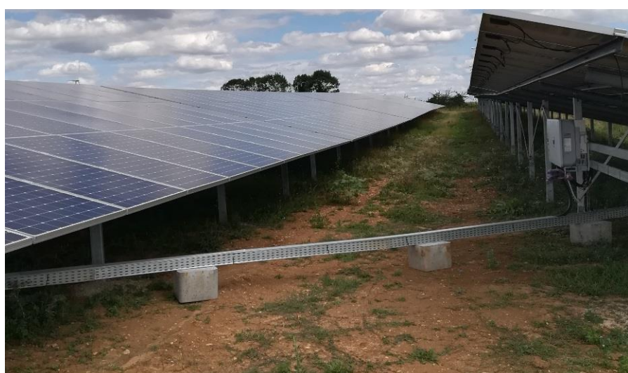
Câbles hors sol – source : LUXEI
