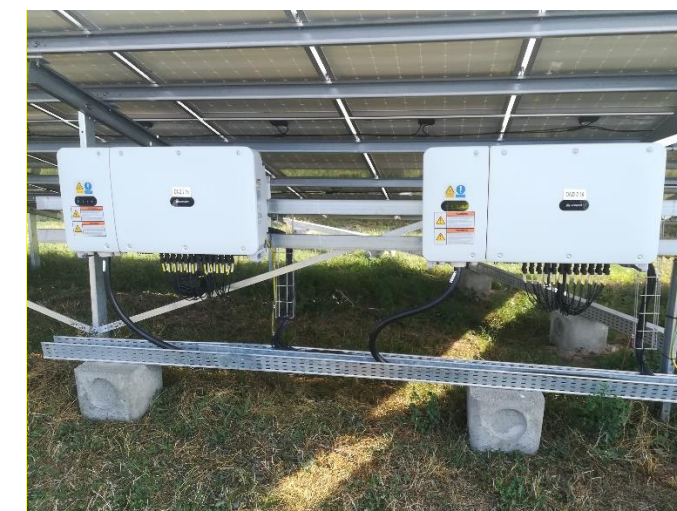
Figure 19. Illustration d'onduleurs strings avec câbles hors sol – Source : EDF Renouvelables France
