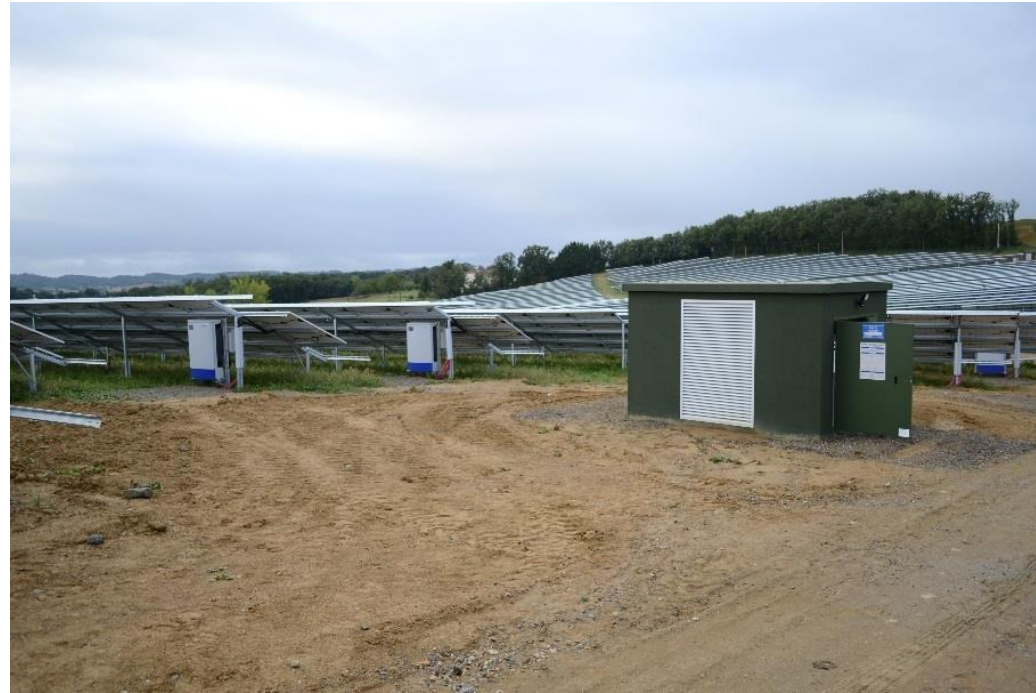
Figure 141. Exemple de poste de transformation couleur RAL 6011 sur un parc solaire
