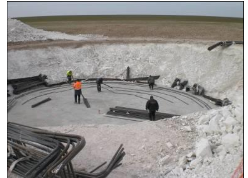
Photo 203 : Exemple de fondations à remettre en état (Source : BE JC)
