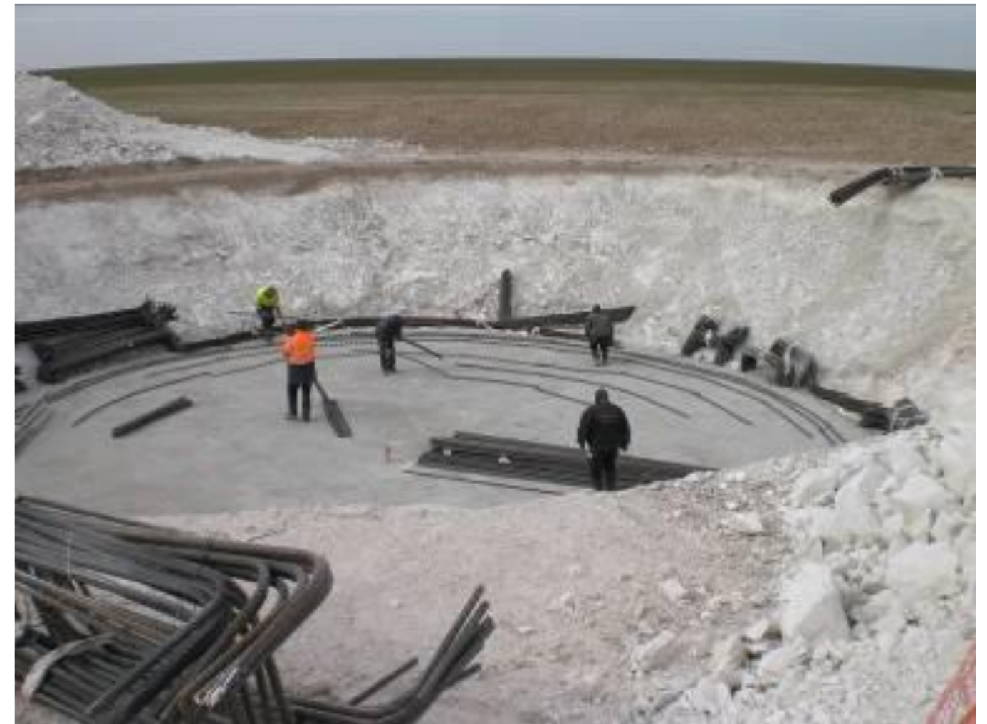
Photo 194 : Exemple de fondation à remettre en état (Source : BE JC)
