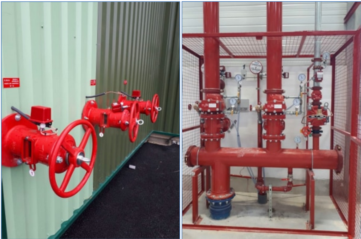
Photographies de poste à vanne murale
