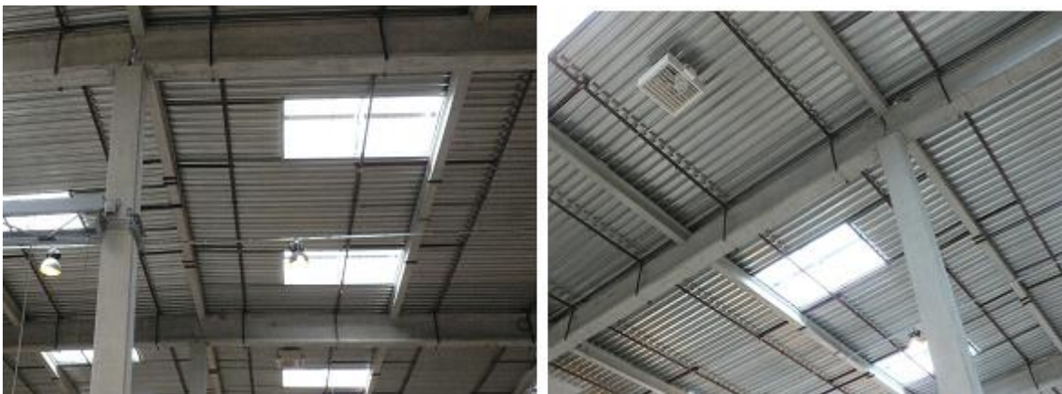
Figure 13 : Dispositifs d'évacuation naturelle des fumées et des chaleurs (DENFC)
