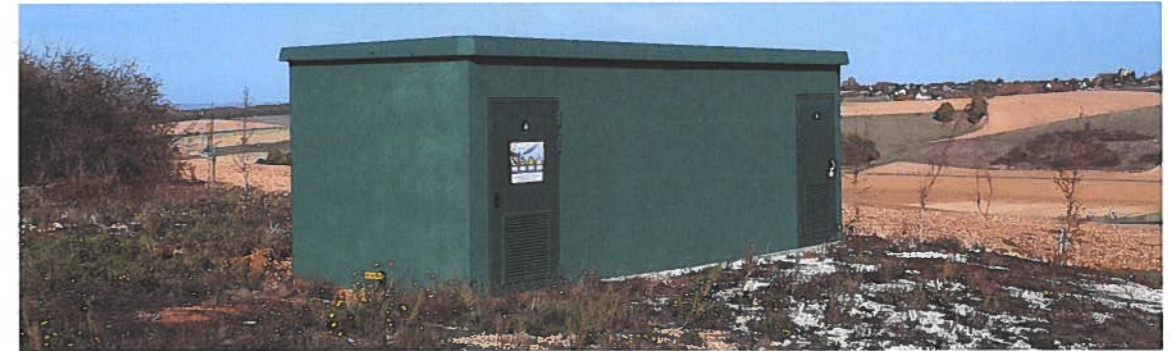
Poste de transformation/livraison : installations similaires
