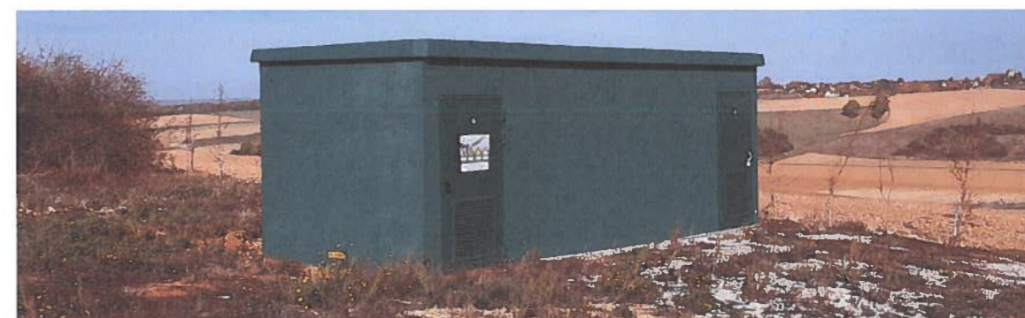
Poste de transformation/livraison : installations similaires
