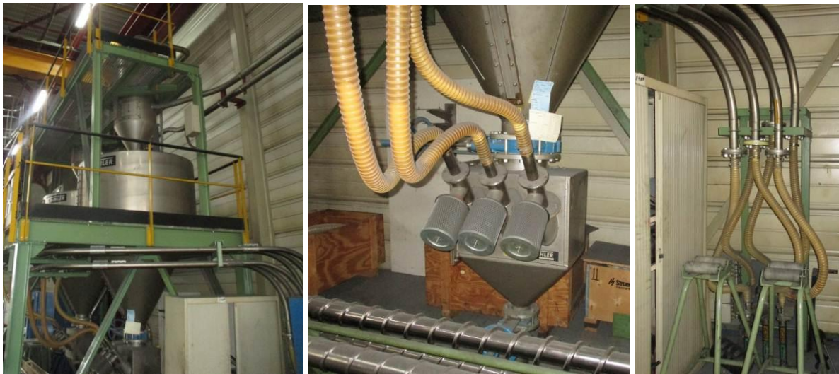
Photos niv 2, extrusion VCMT : avec alimentation en PE depuis le silo et installation d'aspiration des poussières
