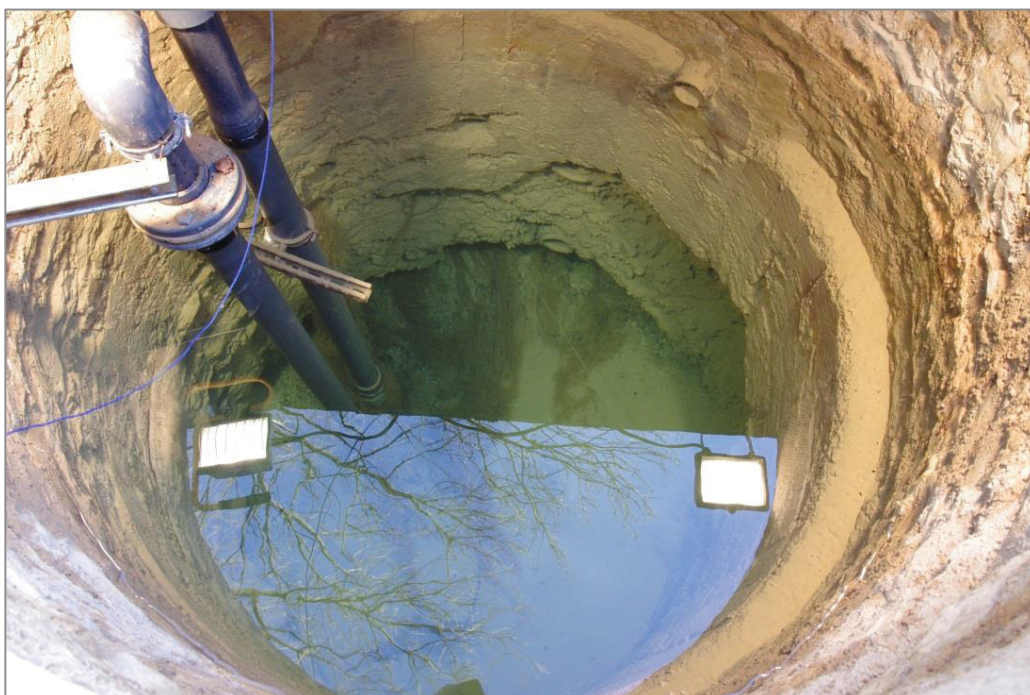
Vue du captage du lavoir vers la station de pompage
