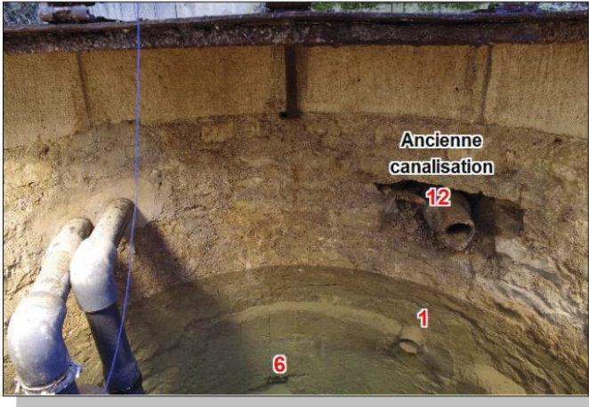
Vue des 2 canalisations de pompage
