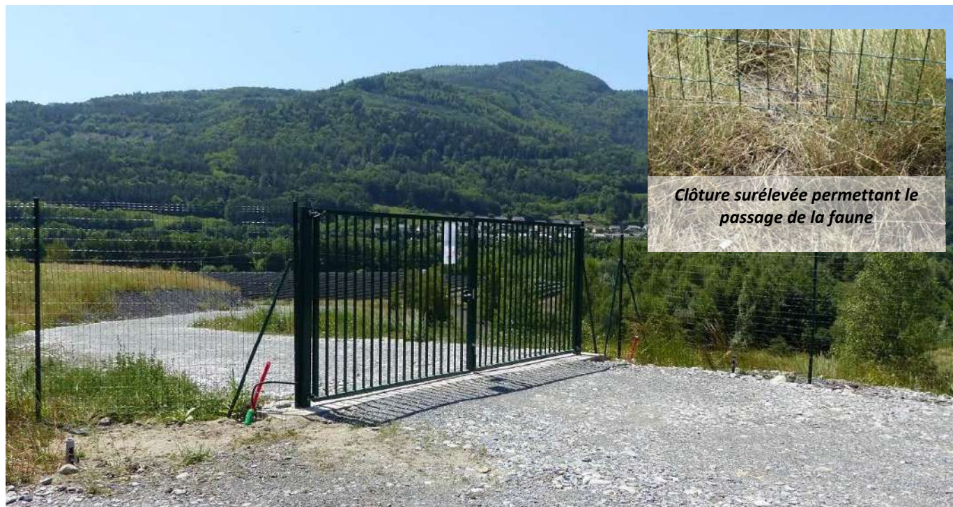
Figure 24: Exemple de portail et clôture sur un parc photovoltaïque (© Corieaulys)
