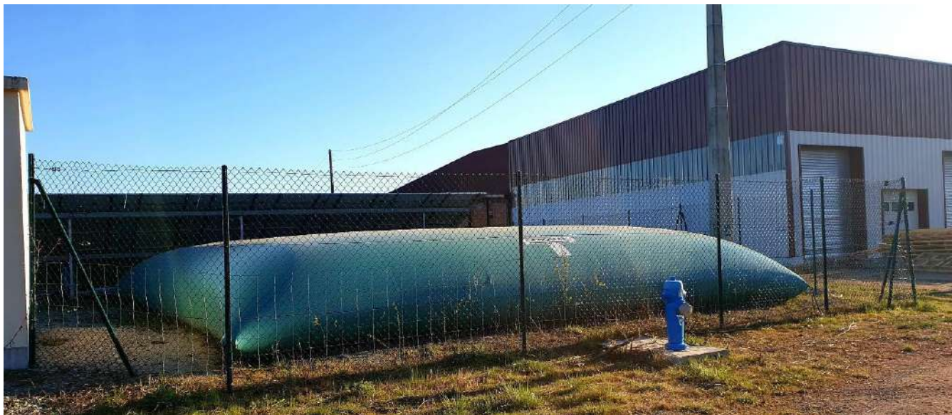
Figure 26 : Exemple de citerne souple sur un parc photovoltaïque dans la Loire (© Corieaulys)
