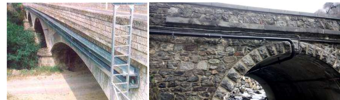
Figure 84 : Exemple de passage de câble par encorbellement A gauche : Installation de goulotte pour passage de câbles (Source : Nogues) - A droite : Passage du réseau électrique dans des tubes acier (Source : 2cordesacordes)
