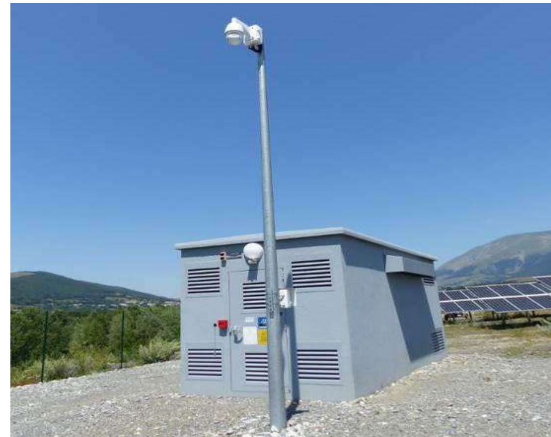
Figure 25 : Vidéo surveillance sur le parc de Susville en Isère (© Corieaulys)
