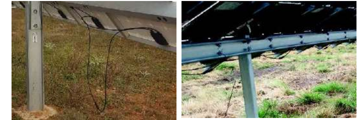
Figure 23 : A gauche, un exemple de câble électrique qui pend et à droite, un exemple de fixation de câbles électriques avec des serre-câbles (Source : IDELE)
