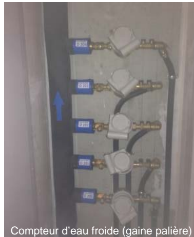
Compteur d'eau froide (gaine palière)
