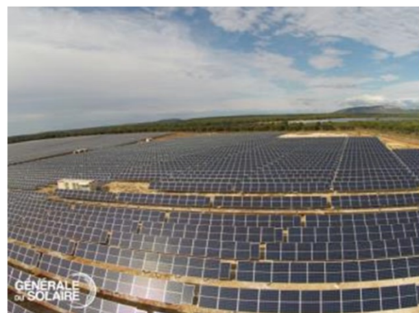
Centrale de Belvezet, Gard
