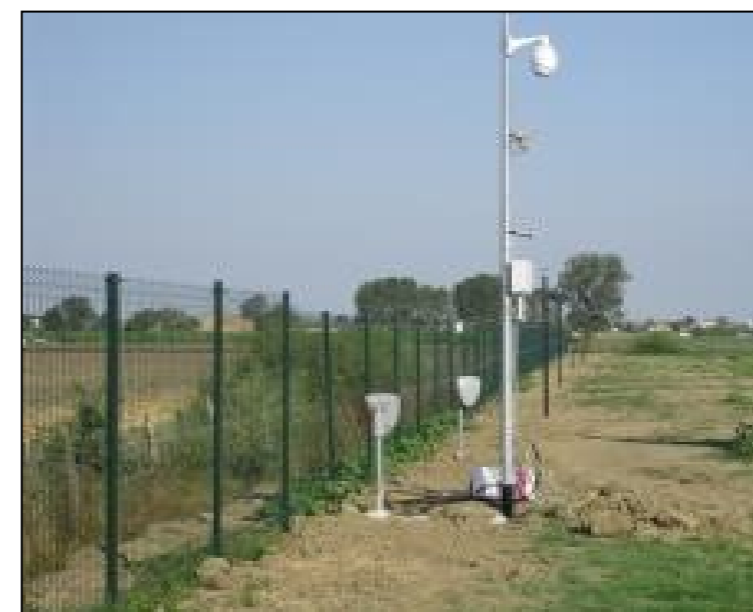
Figure 22 - Exemple de mat de vidéosurveillance
