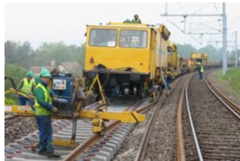
Longs Rails soudés sur traverses béton
