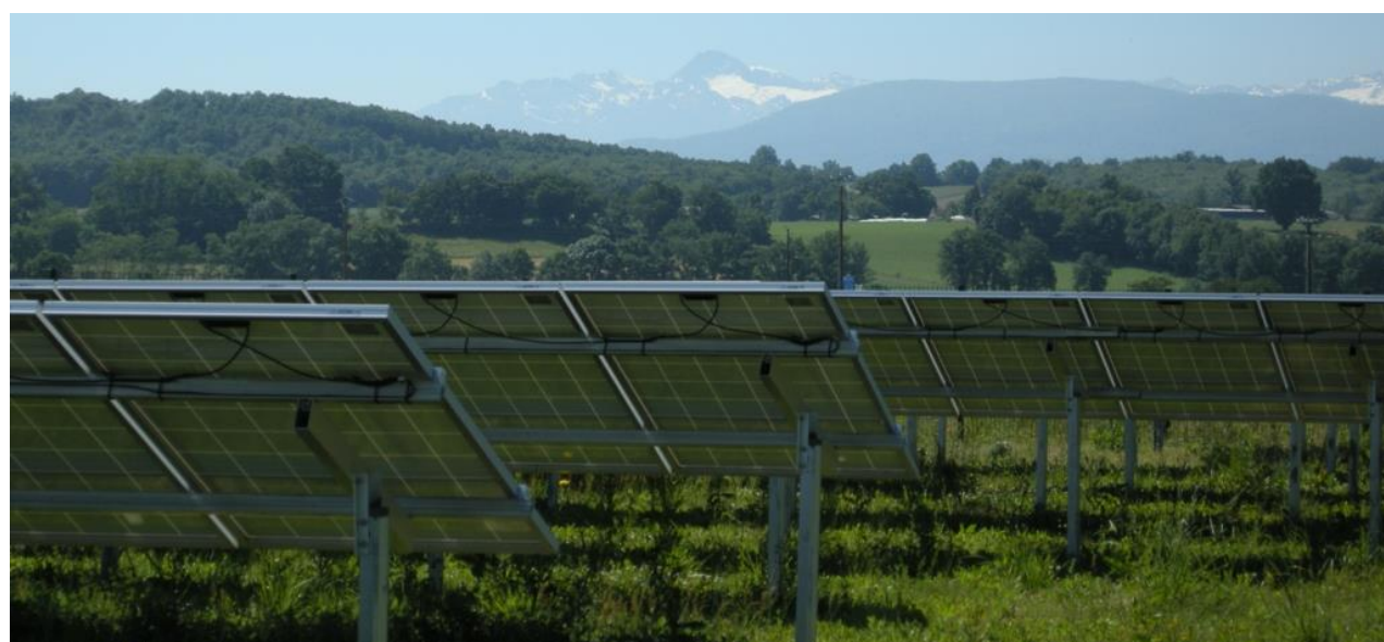
Parc solaire photovoltaïque de Saint-Martory (31)
