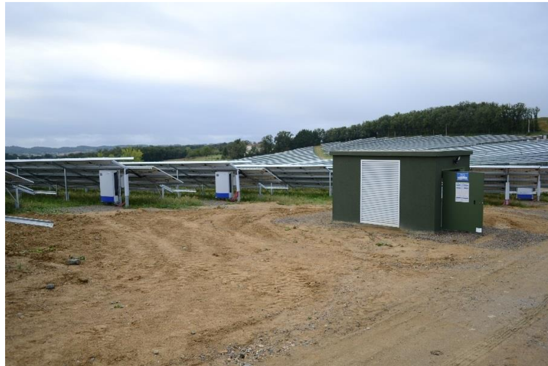
figure 125. Exemple de poste de transformation couleur RAL 6011 sur un parc solaire
