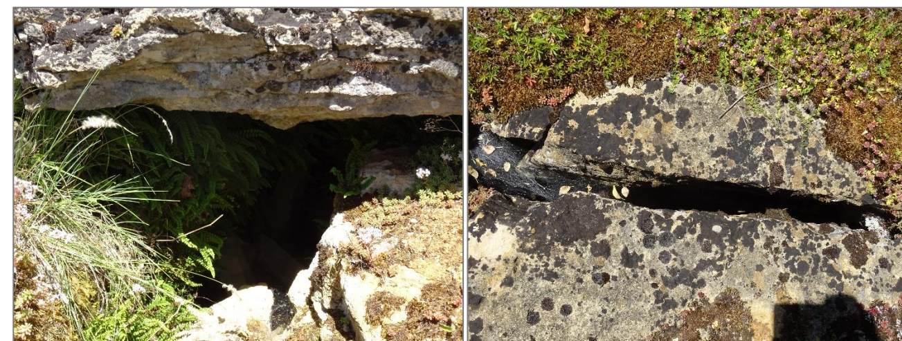
figure 73. Ouvertures des deux cavités karstiques identifiées sur la partie est de la ZIP
