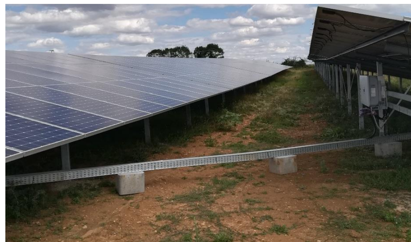
Câbles hors sol – source : LUXEL
