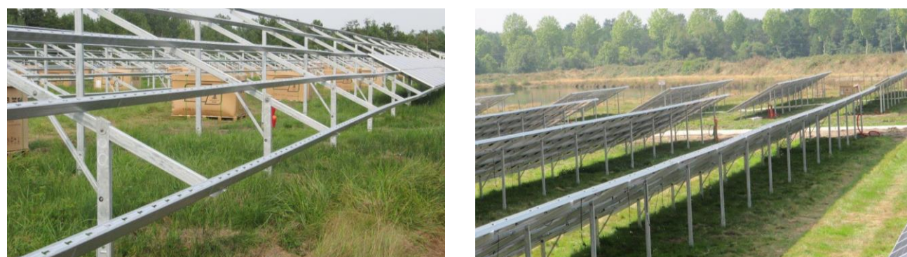
Impacts faibles sur un terrain humide suite à la pose des structures et modules - Source : Luxel, 2013
