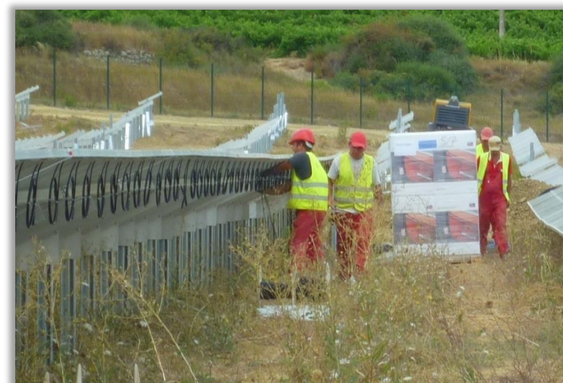
Câblage et interconnexion des modules photovoltaïques
