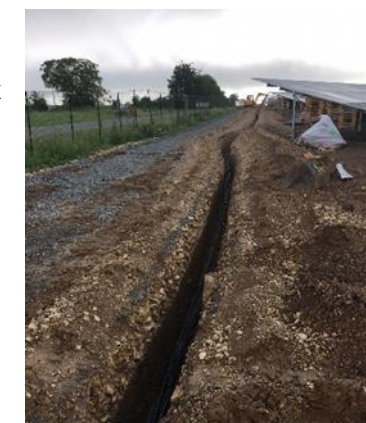
Tranchée pour la pose des câbles enterrés entre les locaux techniques – source : LUXEL
