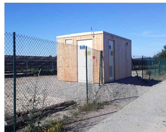
Exemple d'un poste de livraison avec bardage en bois en limite de centrale photovoltaïque (Verneix, Luxel, 2018)
