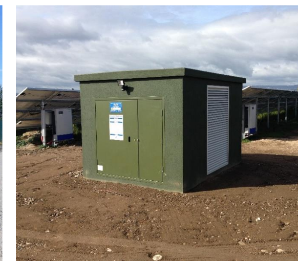
Exemple de poste de transformation sur un parc solaire (Luxel, 2017)
