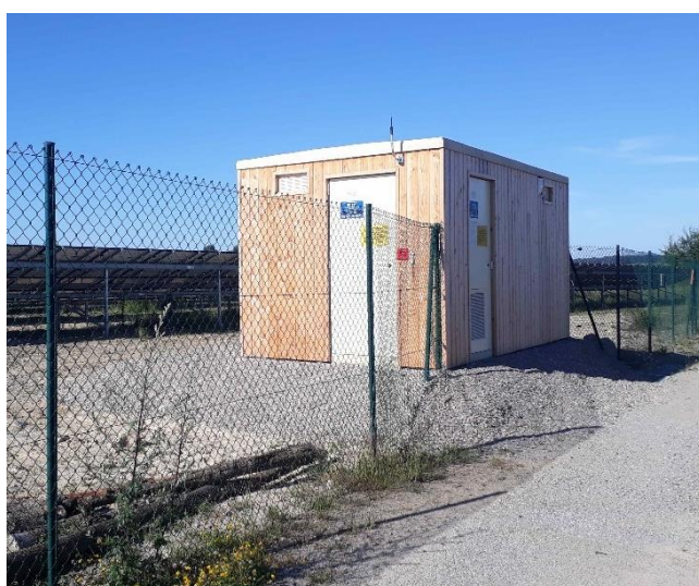
Exemple d'un poste de livraison avec bardage en bois en limite de centrale photovoltaïque (Verneix, Luxel, 2018)
