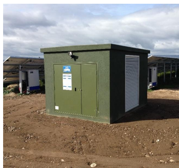
Exemple de poste de transformation sur un parc solaire (Luxel, 2017)
