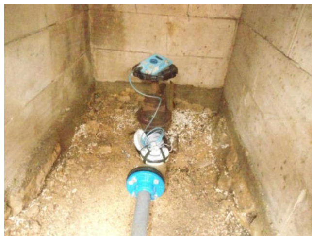
Chambre de comptage
