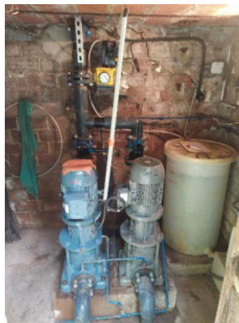
Groupe de pompage
