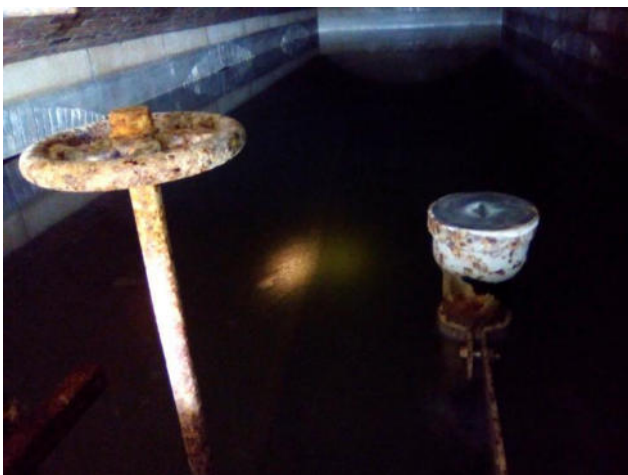
Organes hydrauliques corrodés
