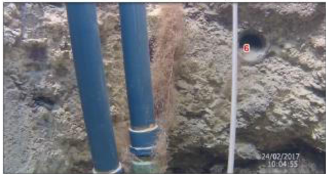
Vue sur le drain 6 et les colonnes de pompage
