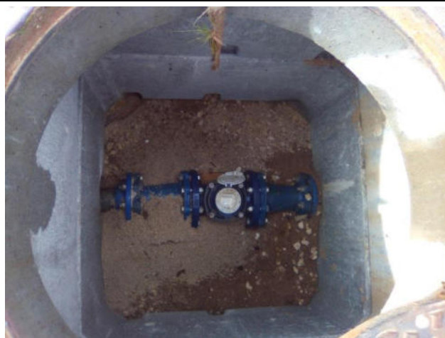
Chambre de comptage
