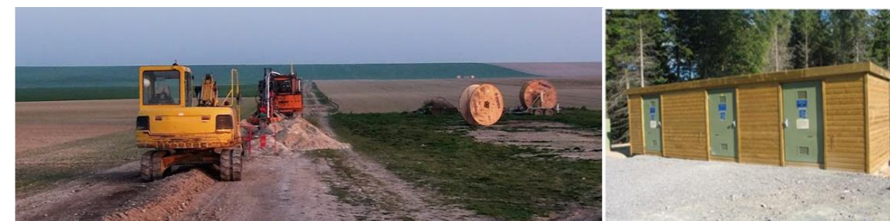
Figure 28: Déroulage et pose des câbles (à gauche), poste de livraison (à droite)
