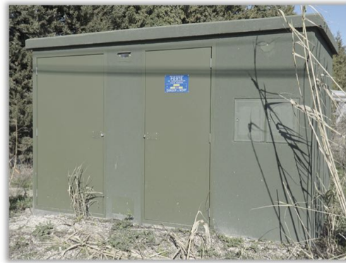
Poste de transformation
