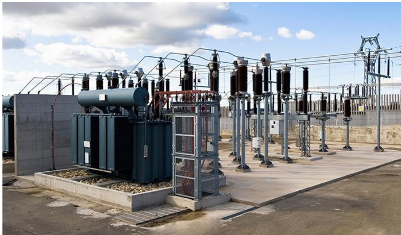
Figure 14. Exemple d'une sous-station d'élévation de la tension (Source : Elo Energy, pour EDF, 2021)
