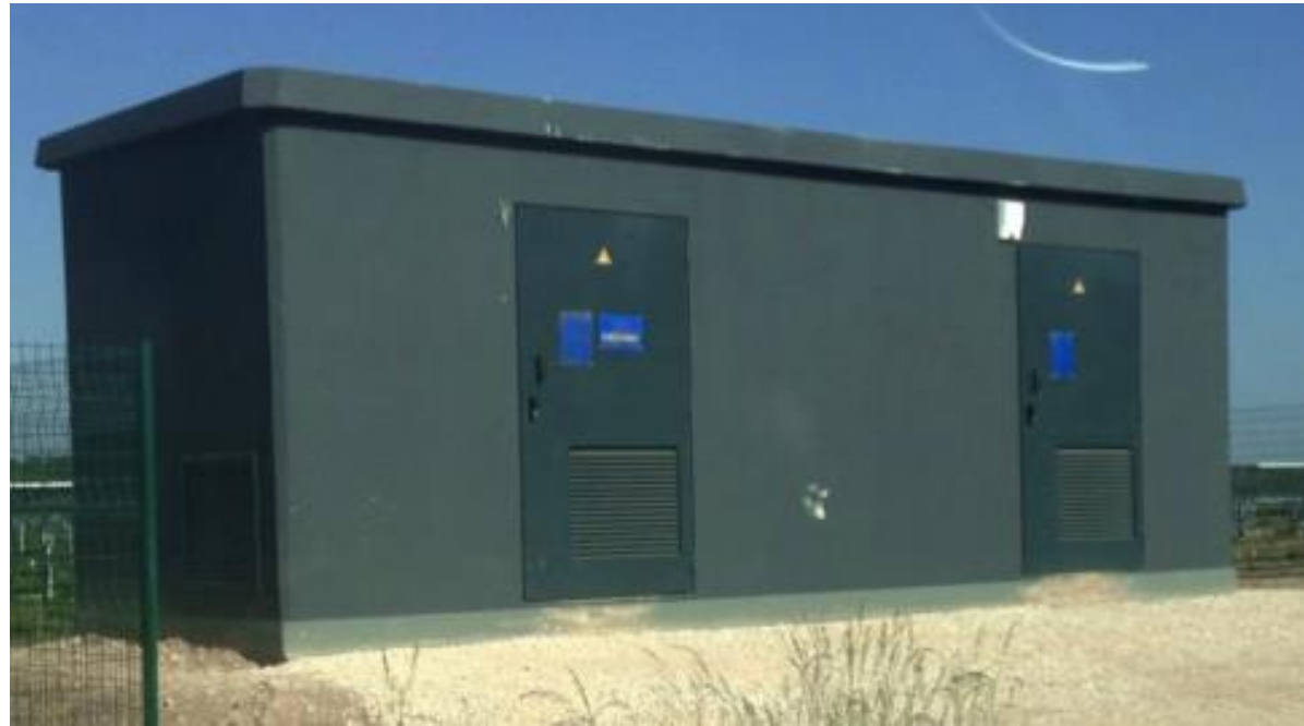
Figure 53. Illustration type d'un poste de transformation
