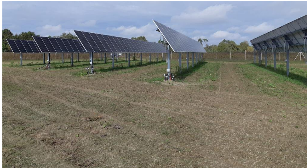
Figure 69. Le pilote Agrolandes au moment de sa mise en service, en septembre 2022
